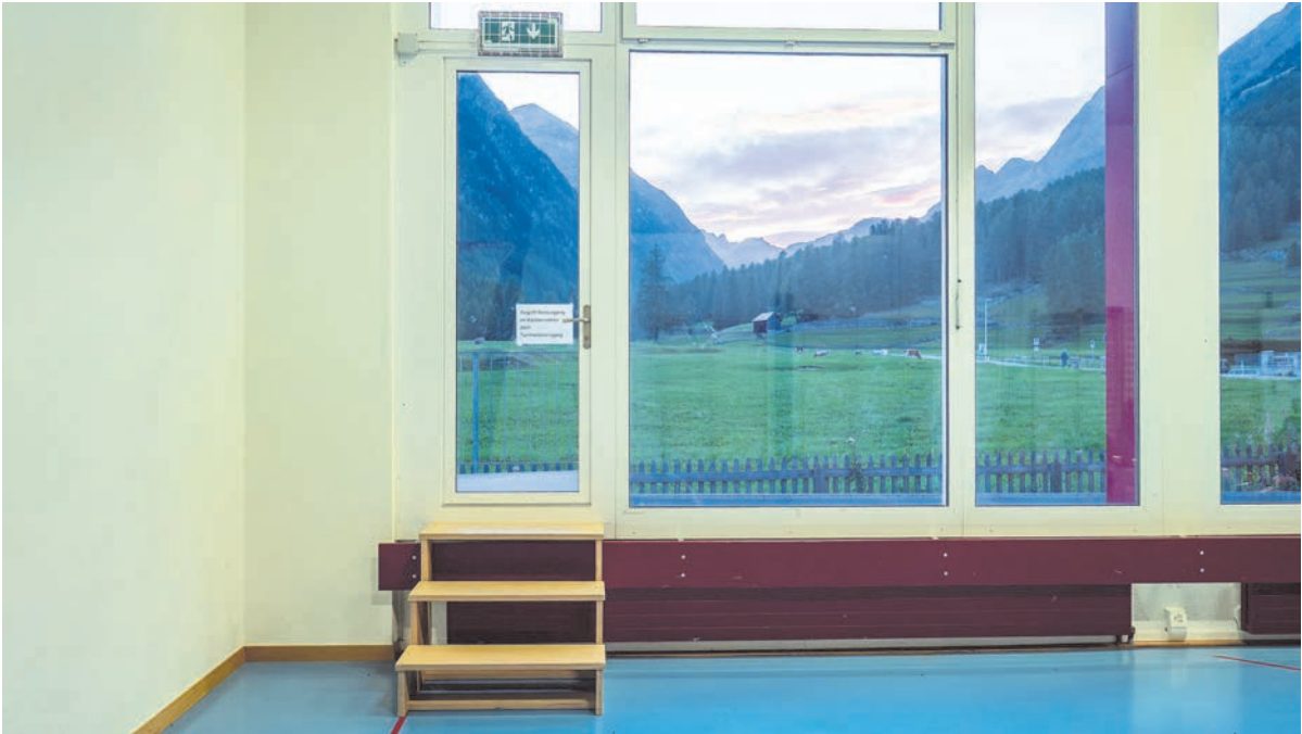
Der direkte, nicht hindernisfreie Notausgang von der Turnhalle des Schulhauses Bever ins Freie müsste im Zuge der Verschärfung der Brandschutzvorschriften verbreitert werden. Fotos: Jon Duschletta
