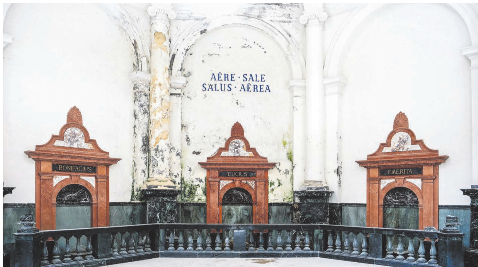
Der Blick in den Kuppelsaal der Büvetta Tarasp zeigt die Dringlichkeit einer baulichen Sanierung.
