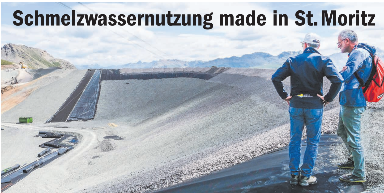
Adrian Jordan (links) mit einem Teilnehmer der Baustellenführung auf dem Damm des neuen Lej Nair Pitschen auf Corviglia. Am 13. August wird der Speichersee vom dafür zuständigen Bundesamt für Energie abgenommen und kann danach kontrolliert mit Schmelzwasser befüllt werden. Foto: Jon Duschletta
