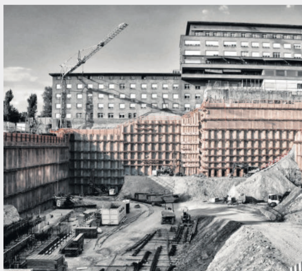
Startschuss für die Filiale Nordbünden, die Aushubarbeiten der Etappe TG/H1 am Kantonsspital Graubünden in Chur im Jahre 2015.
