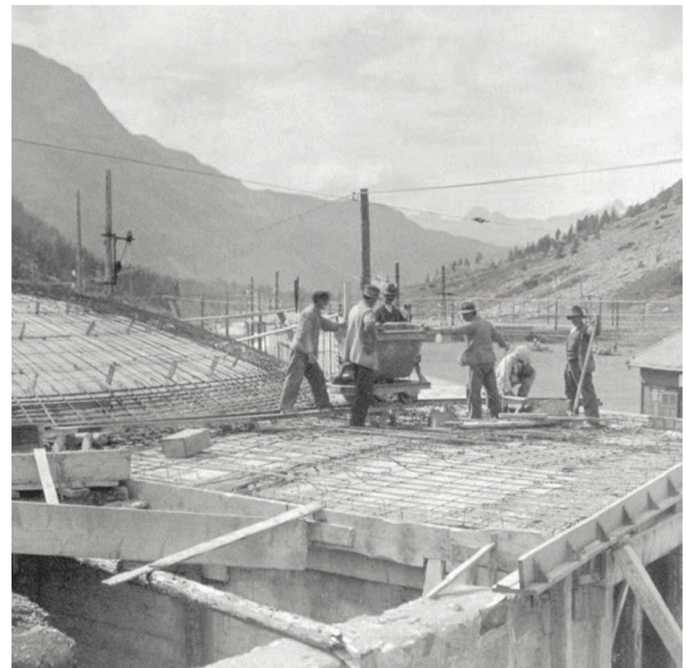
Der Bau der geschützten Drehscheibe und Kohlekaverne bei der damaligen Haltestelle «Berninahäuser».
