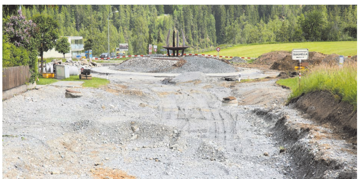
Fingià sainza catram, ma eir amo sainza beton: la piazza da fabrica sülla rondella da Scuol. fotografia: Michael Steiner
