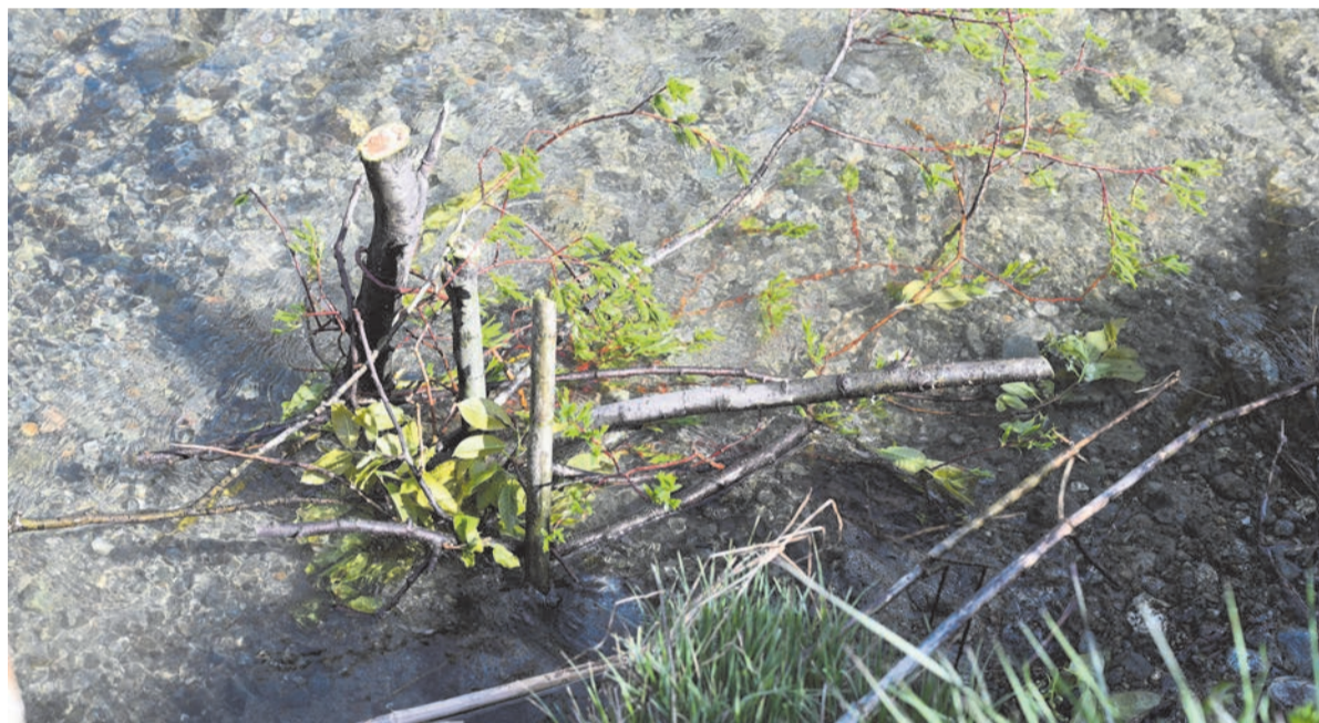
Im Bachbett eingebrachte Weidenstöcke schaffen Vertiefungen in der Sohle, lenken die Strömung und bringen Struktur ins Gewässer.
