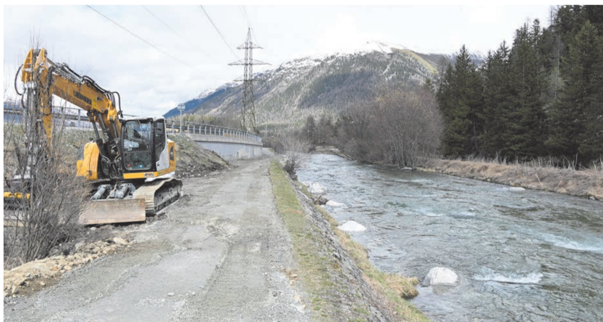
Zurzeit laufen die letzten Inn-Revitalisierungsmassnahmen in Celerina im Bereich «Oben». Der Damm wird etwas erhöht, der Weg verbreitert, in den Inn sind als Instreaming-Massnahmen Natursteinblöcke eingebracht worden. Foto: Reto Stifel
