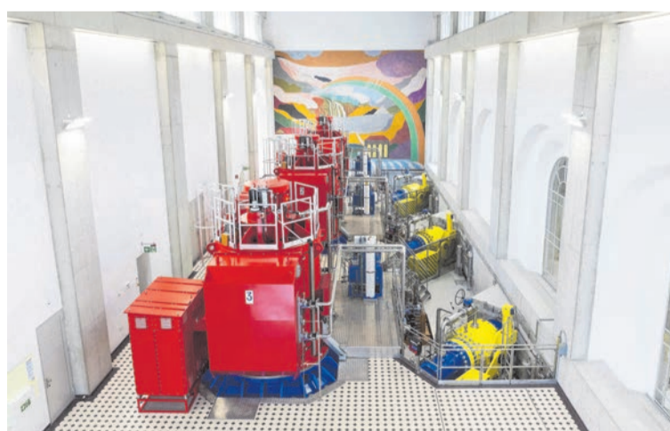
Das Kraftwerk Robbia war nach der Gesamterneuerung einer der Haupttreiber der gestiegenen Stromproduktion der Repower. Foto: Repower
