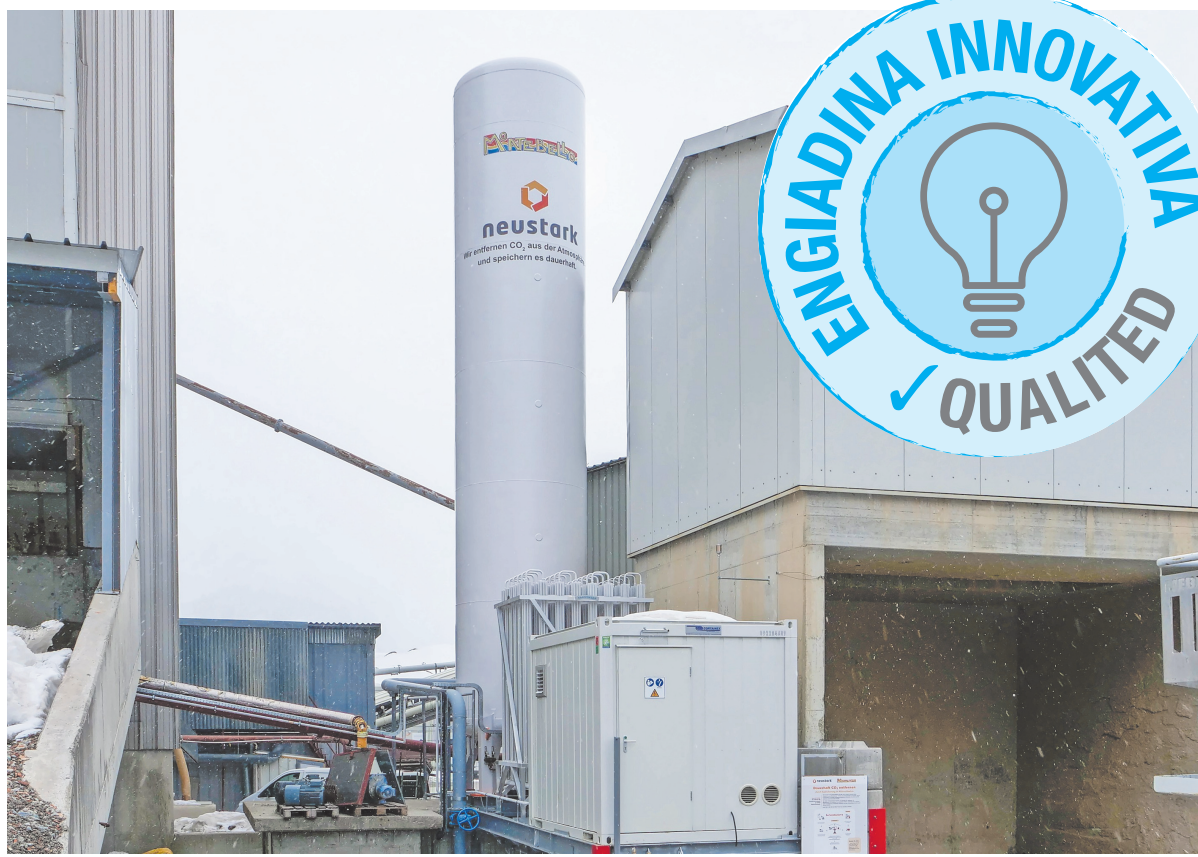
Schlank und rank: Die Neustark-Speicheranlage zur Reduktion von CO 2 in Recyclingbeton auf dem Werksgelände der Montebello AG in Pontresina mit Silo und Technikcontainer. Dazwischen der Verdampfer. Fotos: Jon Duschletta
