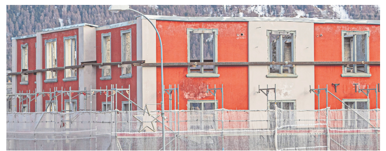
Beim früheren Hotel Misani in Celerina wird so rasch nicht weitergebaut. Gegen das Baugesuch sind Einsprachen eingegangen. Foto: Daniel Zaugg
