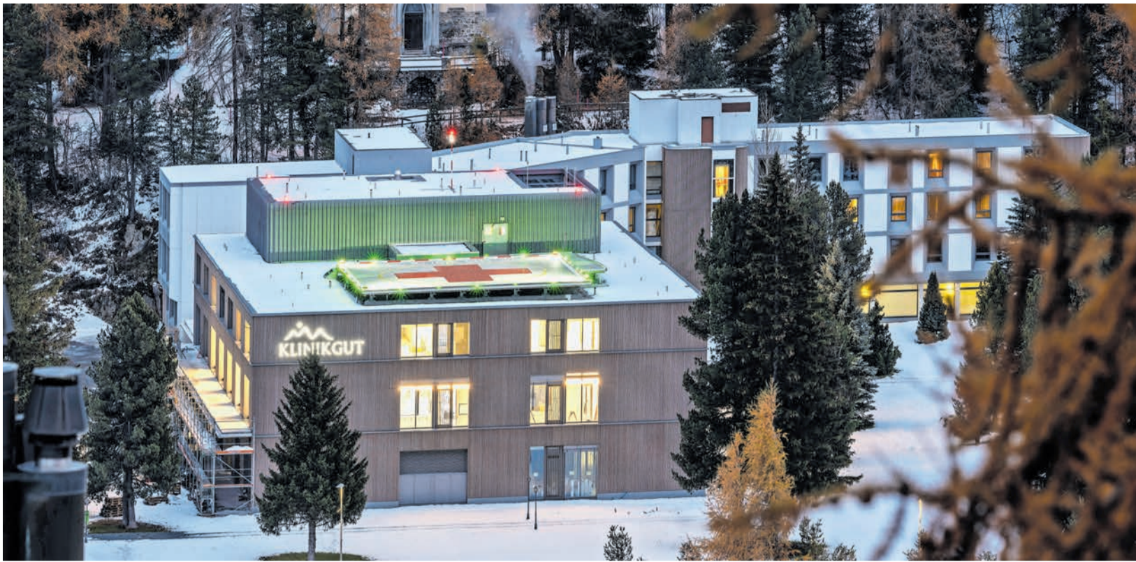
Nach 19 Monaten Bauzeit kann die Klinik Gut am 8. Dezember ihren Betrieb aufnehmen.
