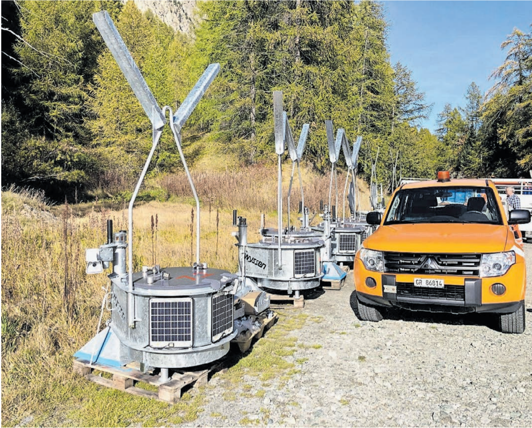
Die Sprengköpfe der Masten, die oberhalb von Sils im Herbst installiert wurden. Foto: Marie-Claire Jur
