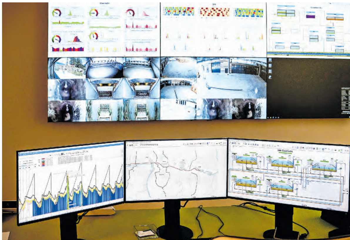
Blick auf die Überwachungs- und Steuerungsmonitore im Kontrollzentrum der ARA Oberengadin. Fotos: Jon Duschletta
