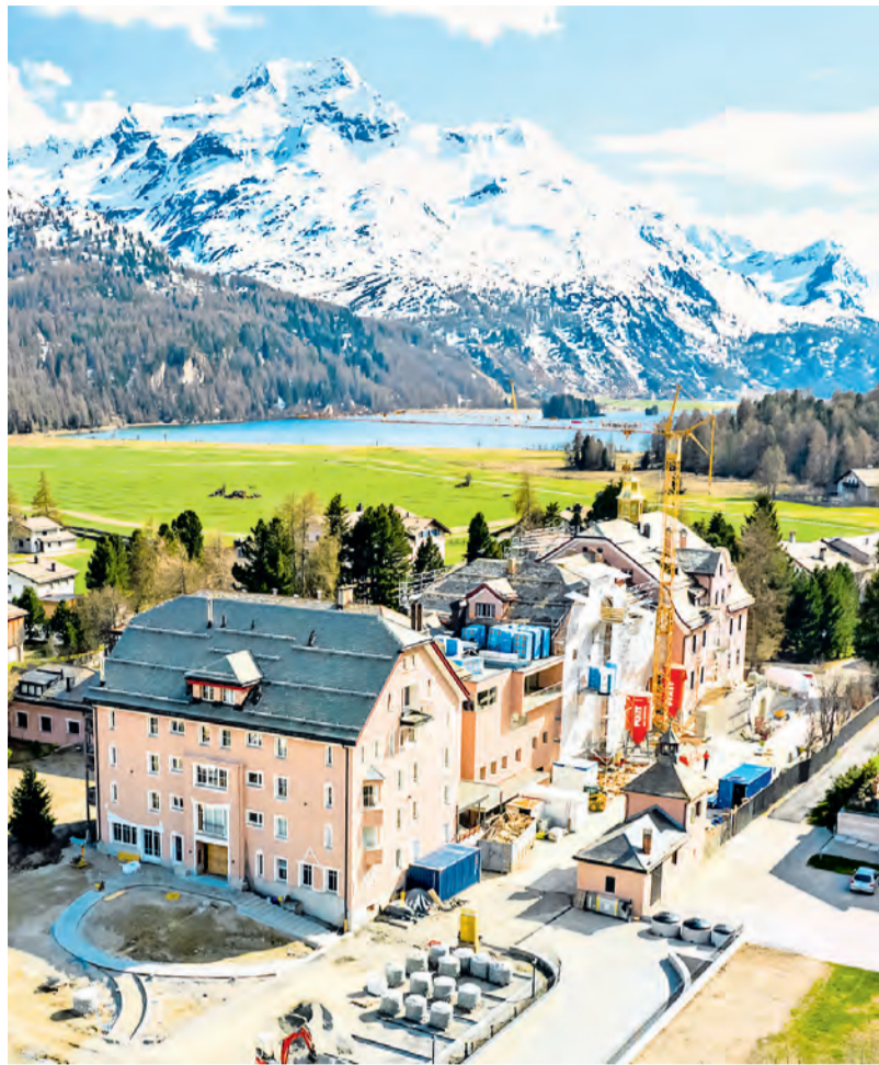
Das Parkhotel Margna in Sils bleibt diesen Sommer zu. Der Umbau des traditionsreichen Silser Hauses braucht mehr Zeit. Vor allem der Einbau des neuen Lifts erweist sich als knifflige Angelegenheit.
