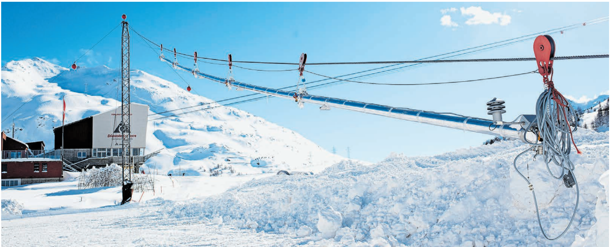
Die Testanlage des Schneiseilsystems befindet sich direkt hinter dem Bahnhof Diavolezza. Dort wird Schnee ab einem Seil mit fünf Düsen produziert.
