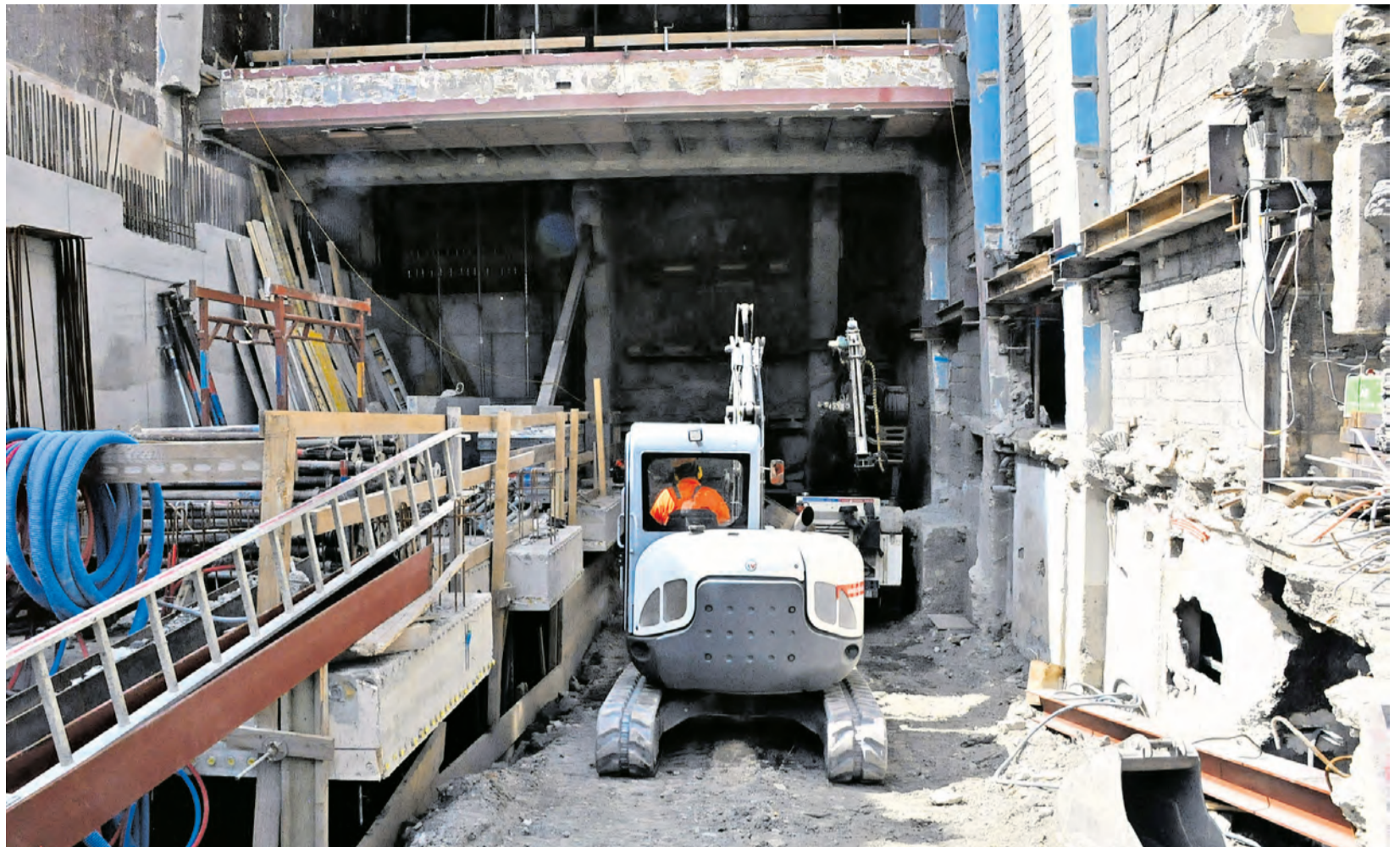
Der Sichtschutz ist weg und gibt den Blick auf die Baustelle preis: Hier befand sich mal der Kinosaal.
