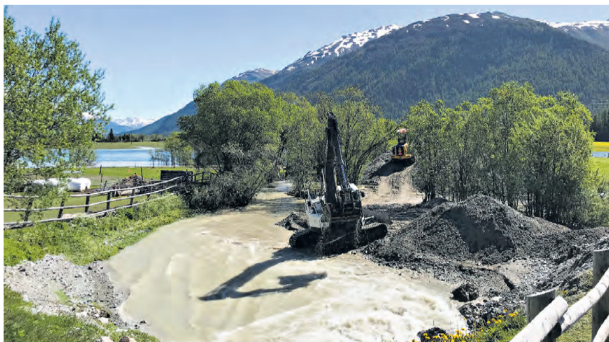
Der Schlattainbach hat in diesem Frühjahr in Celerina Schäden verursacht.
