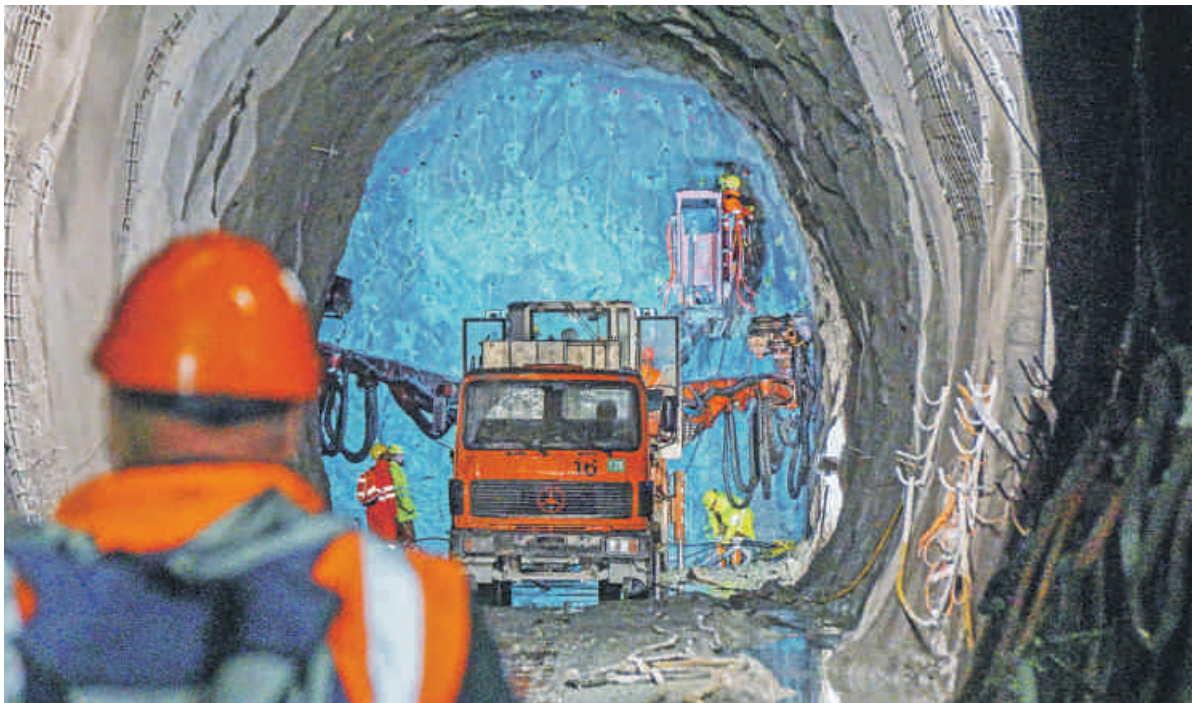
Hell beleuchtet und trotzdem äussert unwirtlich: Der Abschlagplatz Süd des neuen Bahntunnels Albula II. Foto: Jon Duschletta
