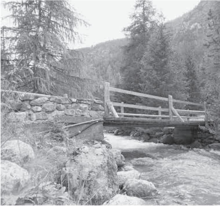
Der Waldweg ins Val Chamuera befindet sich in schlechtem Zustand und muss erneuert werden. Foto: Reto Stifel
