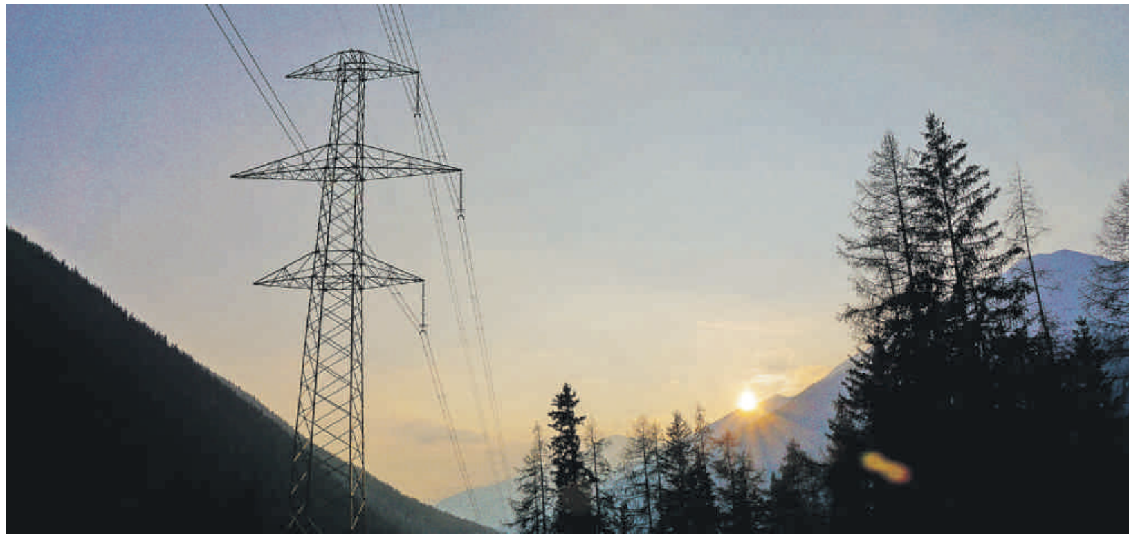
Mit dem Entscheid des Eidgenössischen Starkstrominspektorats kann die Swissgrid den geplanten Strangnachzug auf der bestehenden Hochspannungsleitung zwischen Pradella und La Punt Chamues-ch realisieren. Im Bild die nur zur Hälfte belegte Leitung bei Zernez. Foto: Jon Duschletta
