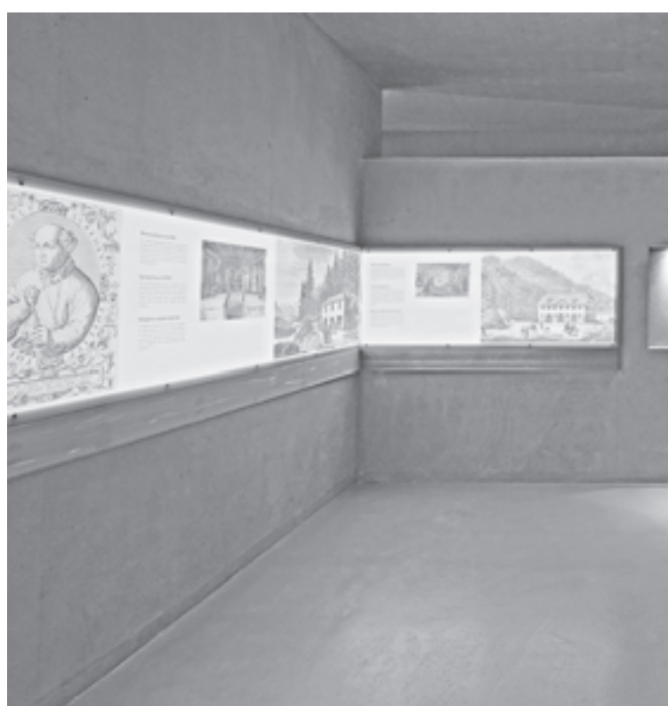
Im Forum Paracelsus dringt Grundwasser ein. Es muss eine Negativabdichtung eingesetzt werden.
