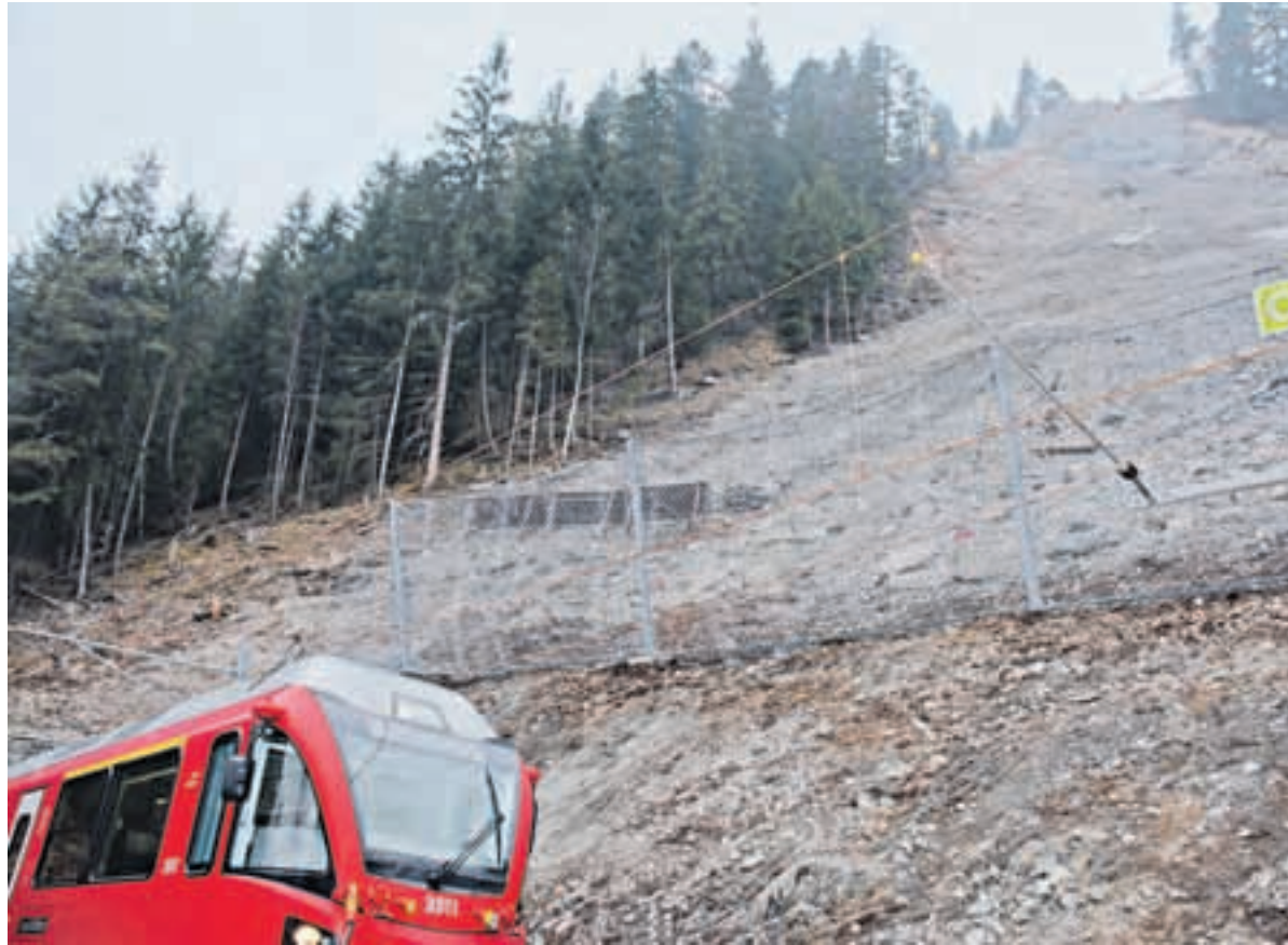
Die RhB ist Naturgefahren stark ausgesetzt und schützt ihr Streckennetz mit Mauern, Schutznetzen (im Bild bei Lüen im Schanfigg), Lawinenrechen und anderem. Aneinandergereiht machen die Schutzwerke 50 km aus. Foto: RhB
