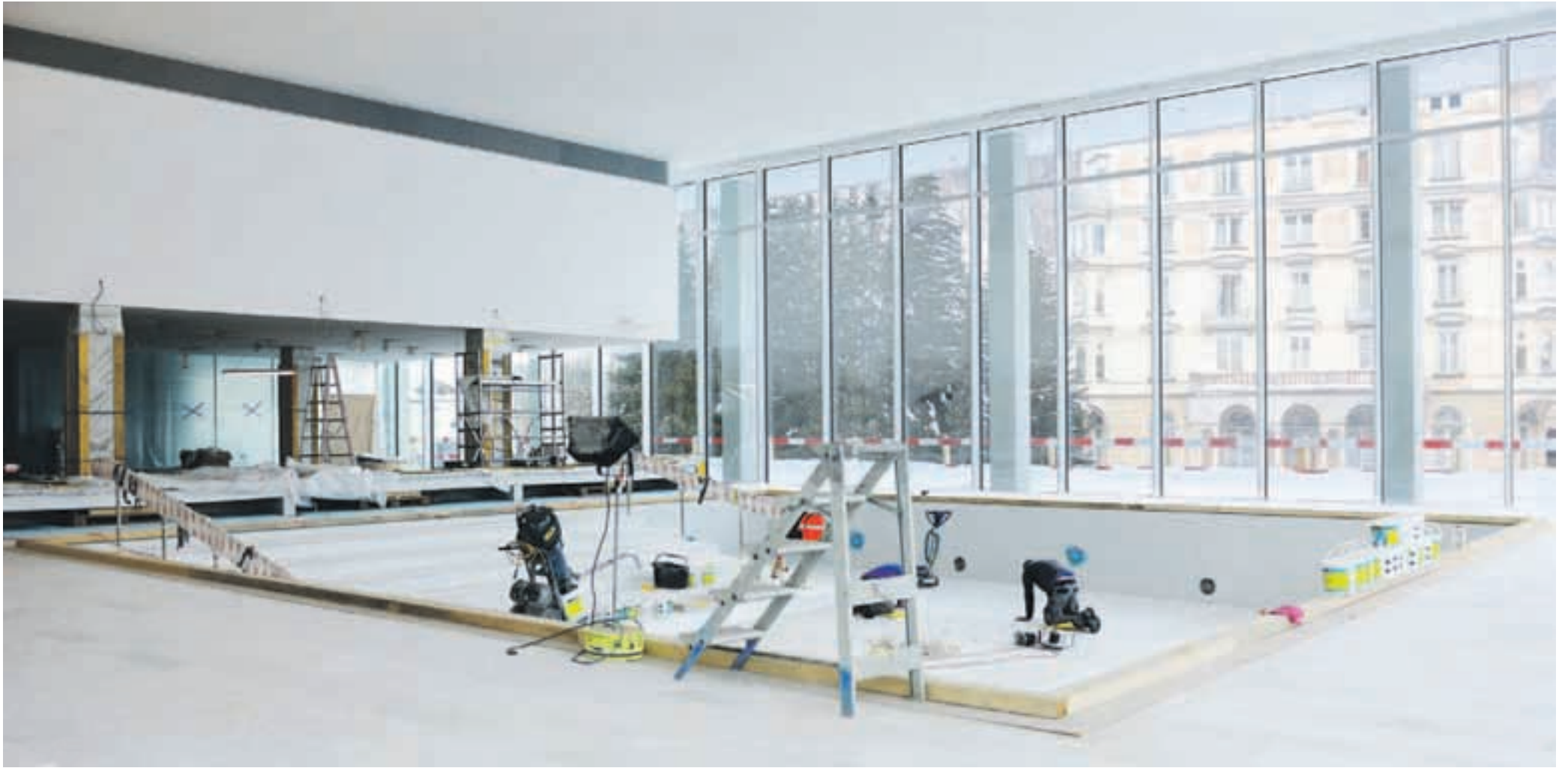
Der Wellnessbereich «hängt» zentral unter der Hauptdecke, sodass die Raumhöhe über den Schwimmbecken höher ist. Der Raum wirkt so noch offener und heller.
