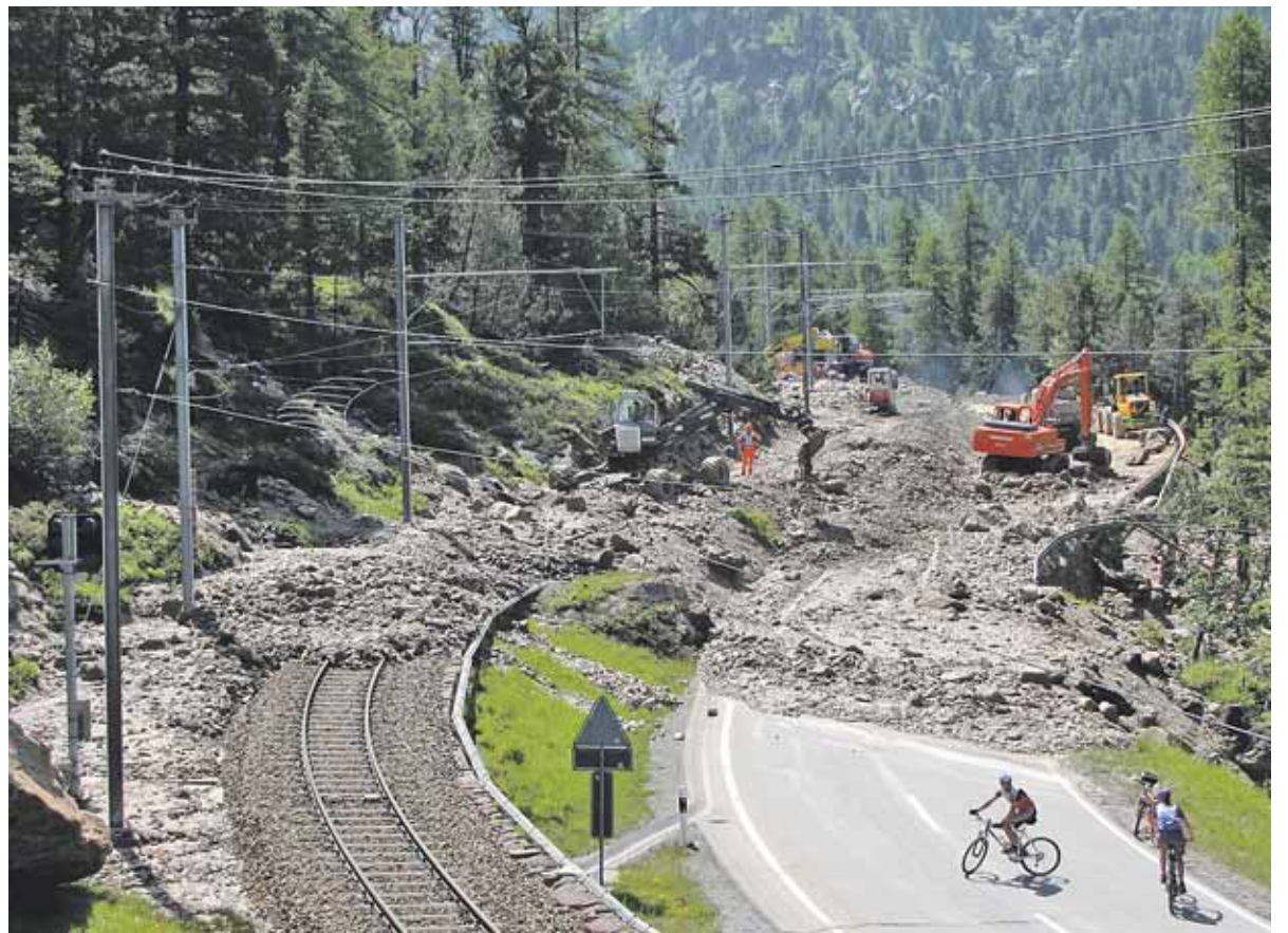
Mehrere Erdbeben verschütteten die Strasse und das Trassè der Rhätischen Bahn zwischen Montebello und Bernina Suot.
