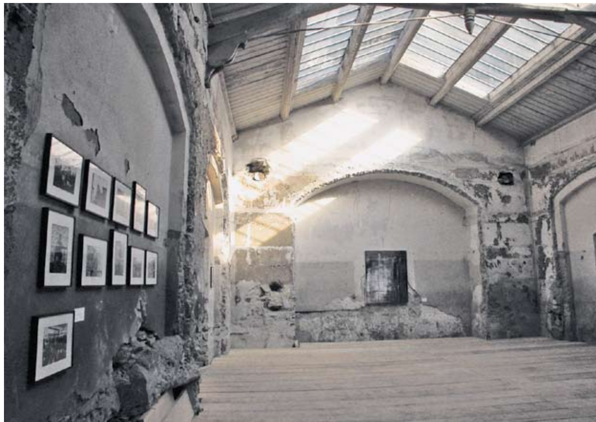
Das St. Moritzer Paracelsusgebäude (im Bild eine Innenansicht) muss saniert werden. Die Planungen zeigen, dass die Kosten weitaus höher sein dürften als ursprünglich angenommen.
