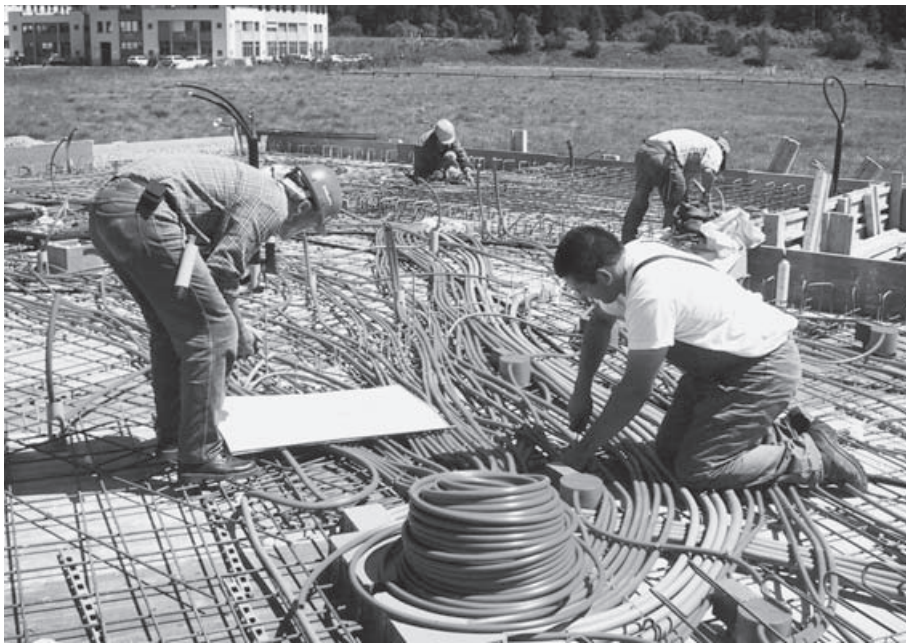
Tägliche Arbeit der Elektromonteur: Das Verlegen der elektrischen Leitungen auf der Baustelle eines Zweifamilienhauses.
